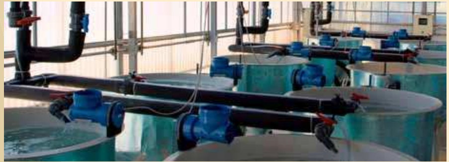
Acuicultura: ejemplo de instalación de automatización en piscifactoría.
